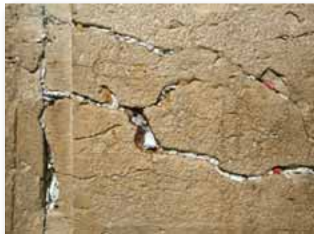
Znaki w pęknięciach ściany świątynnej
